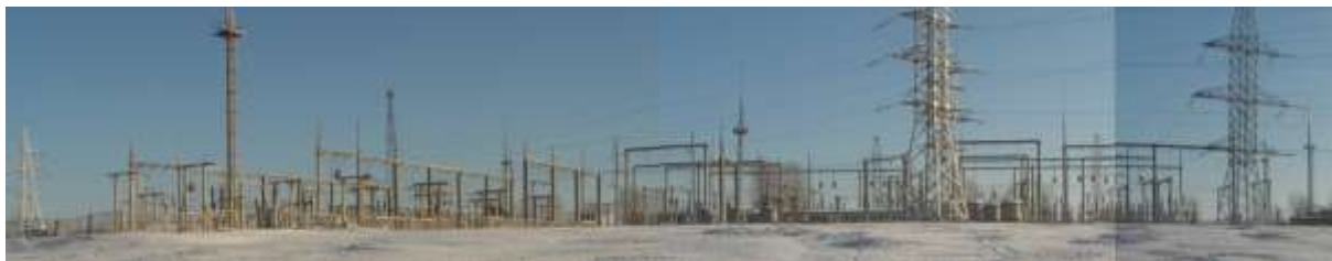
2.2-р зураг. Төслийн талбайн зүүн талд байрладаг Дархан-Эрдэнэтийн 220 кВ-ын дэд станц
